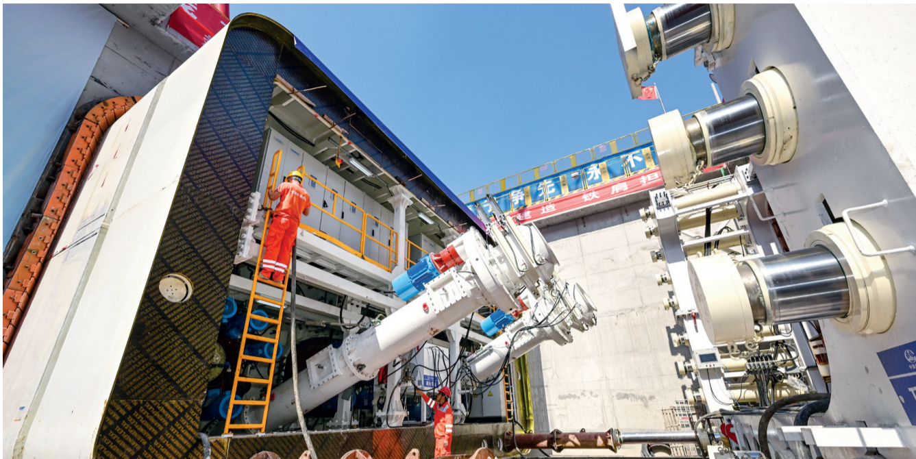
检查设备运转情况
