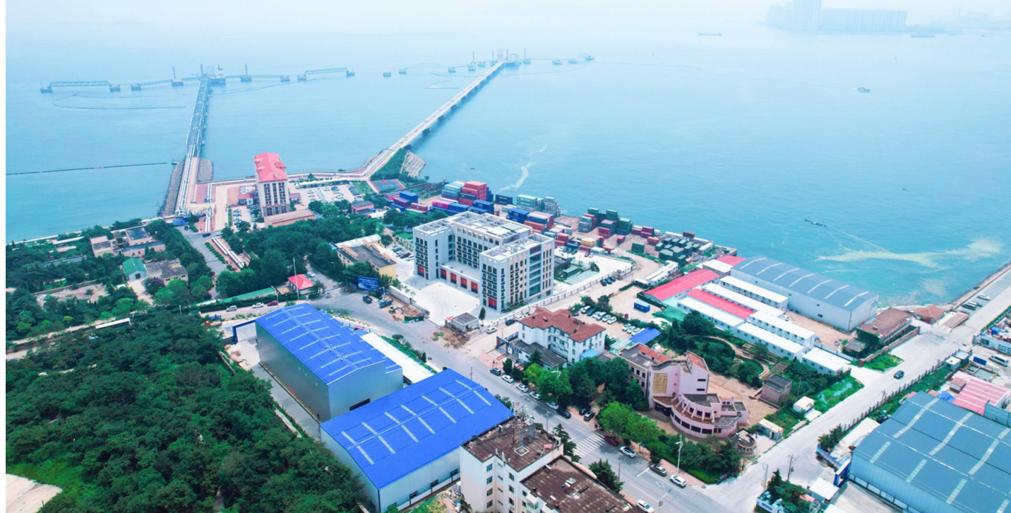
世界最大海底道路隧道——胶州湾第二海底隧道竖井施工 王天翔 摄(影像四局)
