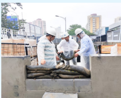
7月29日,安装公司北京地铁12号线机电3标项目部各站防汛防汛工作进行安排部署,要求各站站长和安全员每天对污水泵、排水管重点部位进行巡查,做好安全巡视记录,全力保障汛期施工安全和参建人员生命财产安全。 高旭涛 陈欣彤
