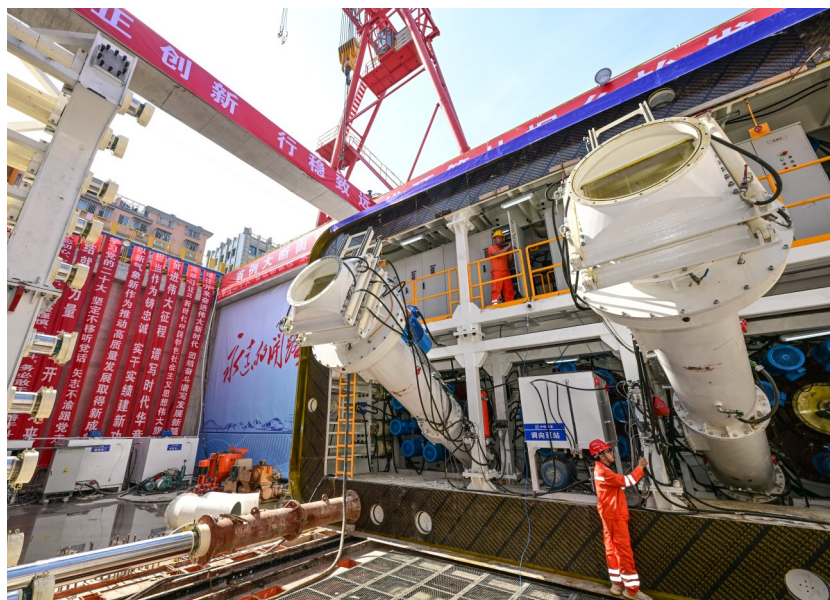
工程技术人员辅助测量顶管机顶进距离 郑瑞东 摄(影像四局)
