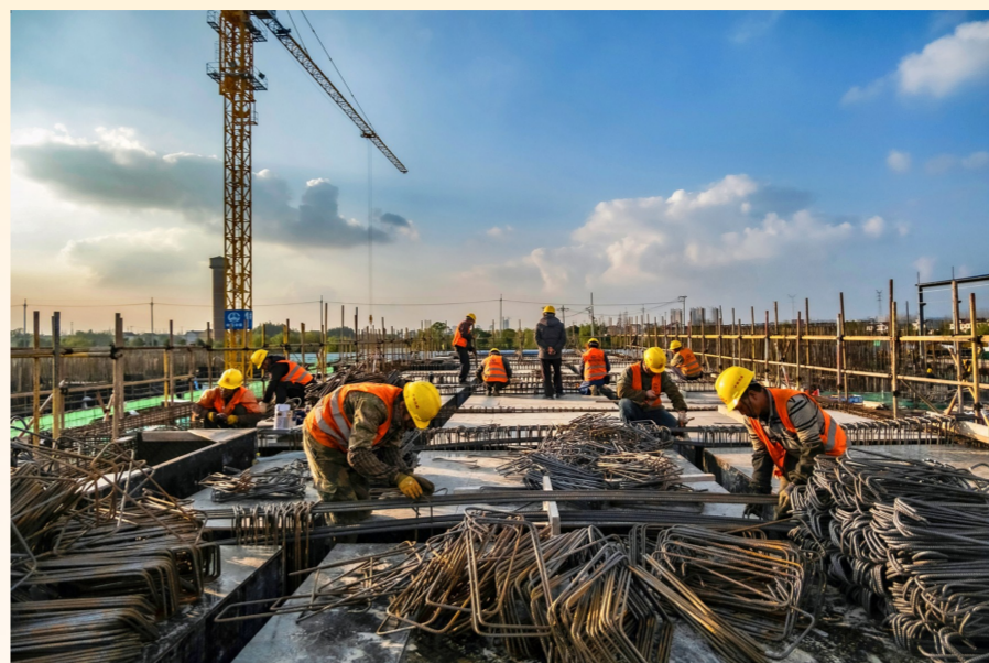
胡效民 摄 上海公司启东水环境项目 建设者抢抓施工黄金期快速推进沉井顶板梁钢筋绑扎施工
