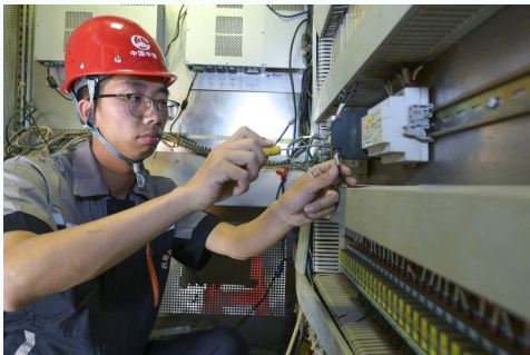
何源正在进行日常维护与电器设备“体检”
