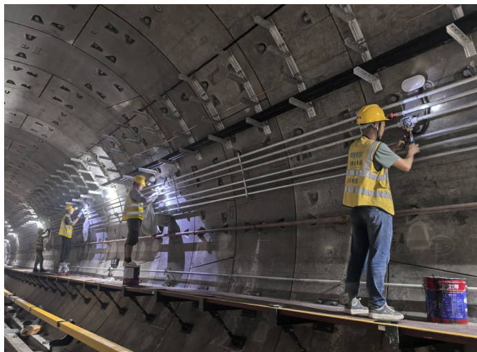
区间灯具接线
