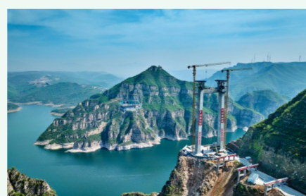
2023年12月12日,大桥主塔封顶,两根巍峨的塔柱矗立黄河之上,遥看对岸山巅。
