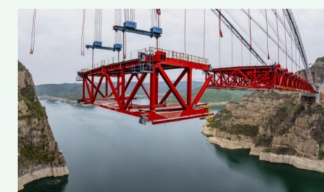
2025年5月13日,深红的钢桁梁被稳稳的吊装拼接,一节连着一节,仿佛碧波之上弹奏的华章。
