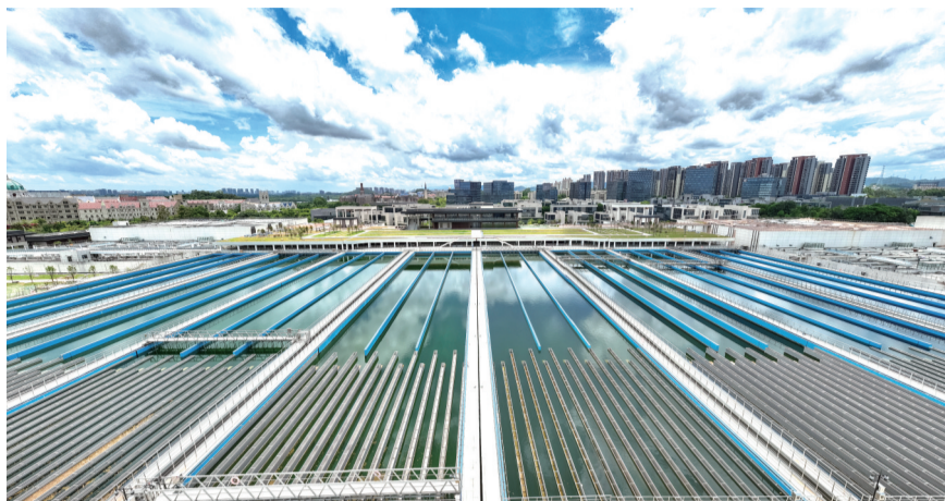
东莞配套松山水厂一期工程试运行供水
