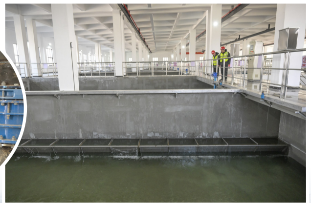
管理人员观察砂滤池反冲洗运转情况
