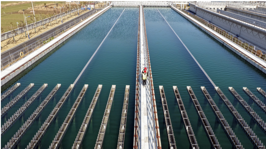
管理人员观察折板絮凝池制水情况
