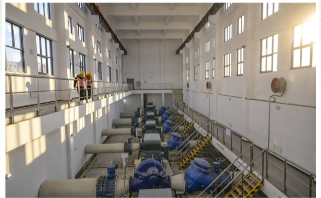
管理人员巡查二级泵房设备运行情况
