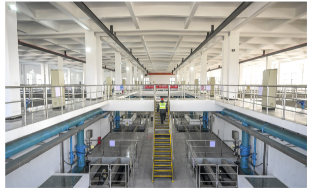
砀山县城乡供水一体化工程砂滤车间
