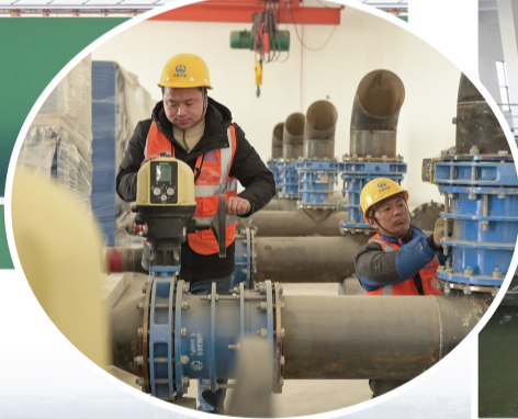
工人正在调试气冲阀门
