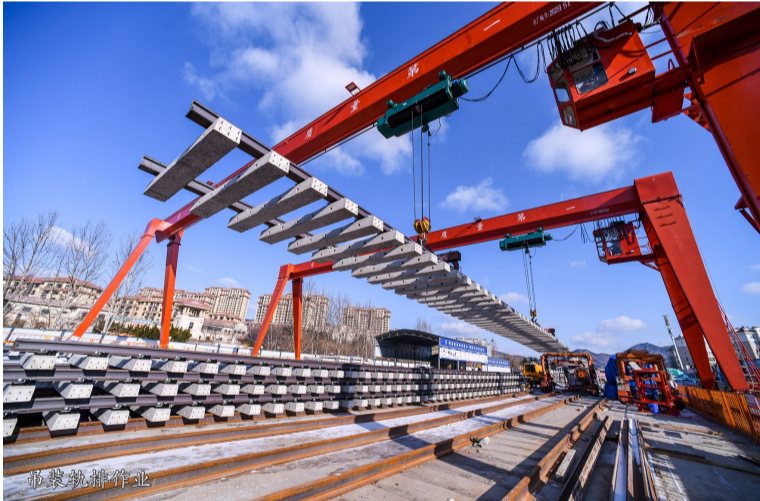
4月15日，中铁四局参建的青岛轨道交通2号线二期工程全线轨通，为后续供电、通信、信号等专业施工创造有利条件。该工程线路全长8.9公里，中铁四局承担全线轨道施工任务，包括整体道床、单开道岔、交叉渡线的铺设以及全线疏散平台、支架等附属工程。
