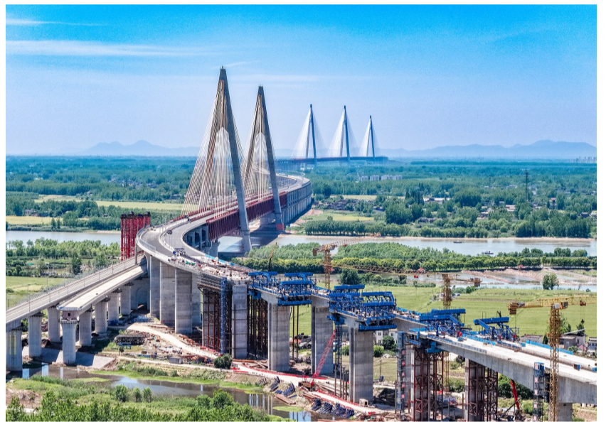
5月13日,中铁四局四公司承建的巢(湖)马(鞍山)城际铁路长江公铁大桥公路接线工程跨乙字河悬臂连续梁右幅顺利完成合龙。该工程全长4.472公里,施工范围涵盖桥梁、道路、给排水、绿化等多项内容。本次合龙的跨乙字河连续梁总长338米,最大跨度158米,为全线同类型桥梁跨径之最。 刘志旭 李友强 摄
