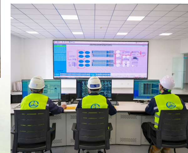
乌兰巴托中央污水处理厂中央控制室
