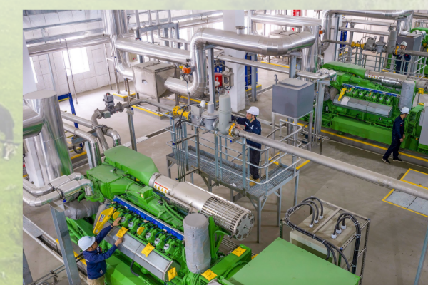
乌兰巴托中央污水处理厂沼气发电机房
